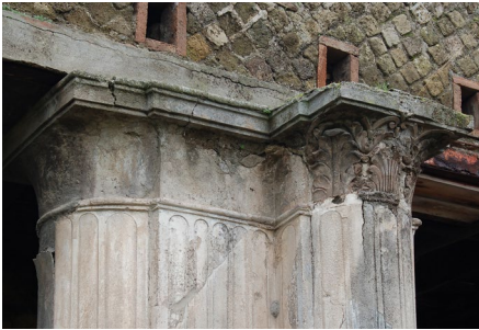
Fig. 25. Ercolano, Casa d'Argo. Il precario stato di conservazione dell'ornato del pilastro dell'angolo nord-orientale del peristilio (foto D. Esposito; © MIC-Parco Archeologico di Ercolano).
