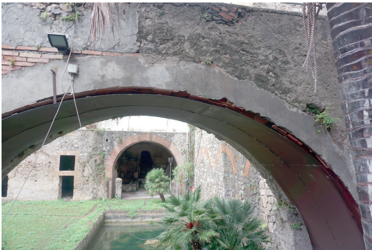
Fig. 19. Particolare dell'arco di passaggio tra il giardino e il porticato esterno ricostruito. Si noti il degrado della struttura in calcestruzzo armato e pignatte curve e la lamiera metallica realizzata recentemente per mettere in sicurezza l'area.
