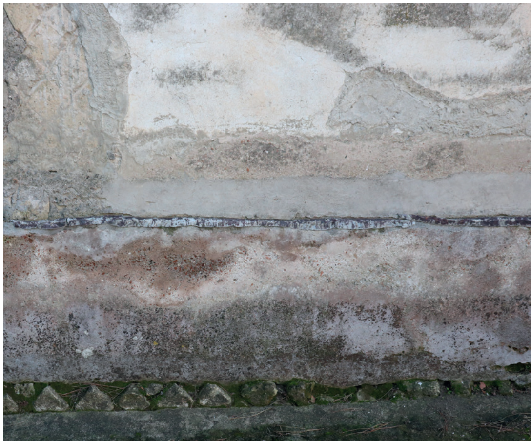
Fig. 8. Lamina in piombo inserita durante gli interventi degli anni Cinquanta come barriera all'umidità di risalita (foto dell'autore 2019).
