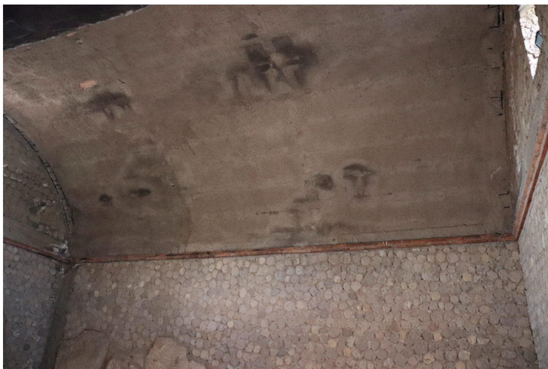
Fig. 6. Copertura voltata del calidarium realizzata in laterocemento durante gli anni Cinquanta. Si notino il pessimo stato di conservazione, determinato dalla caduta dei copriferrì e dalla presenza di macchie di umidità da infiltrazione, e i paramenti ricostruiti in opera incerta sulla muratura antica (foto dell'autore, 2019).
